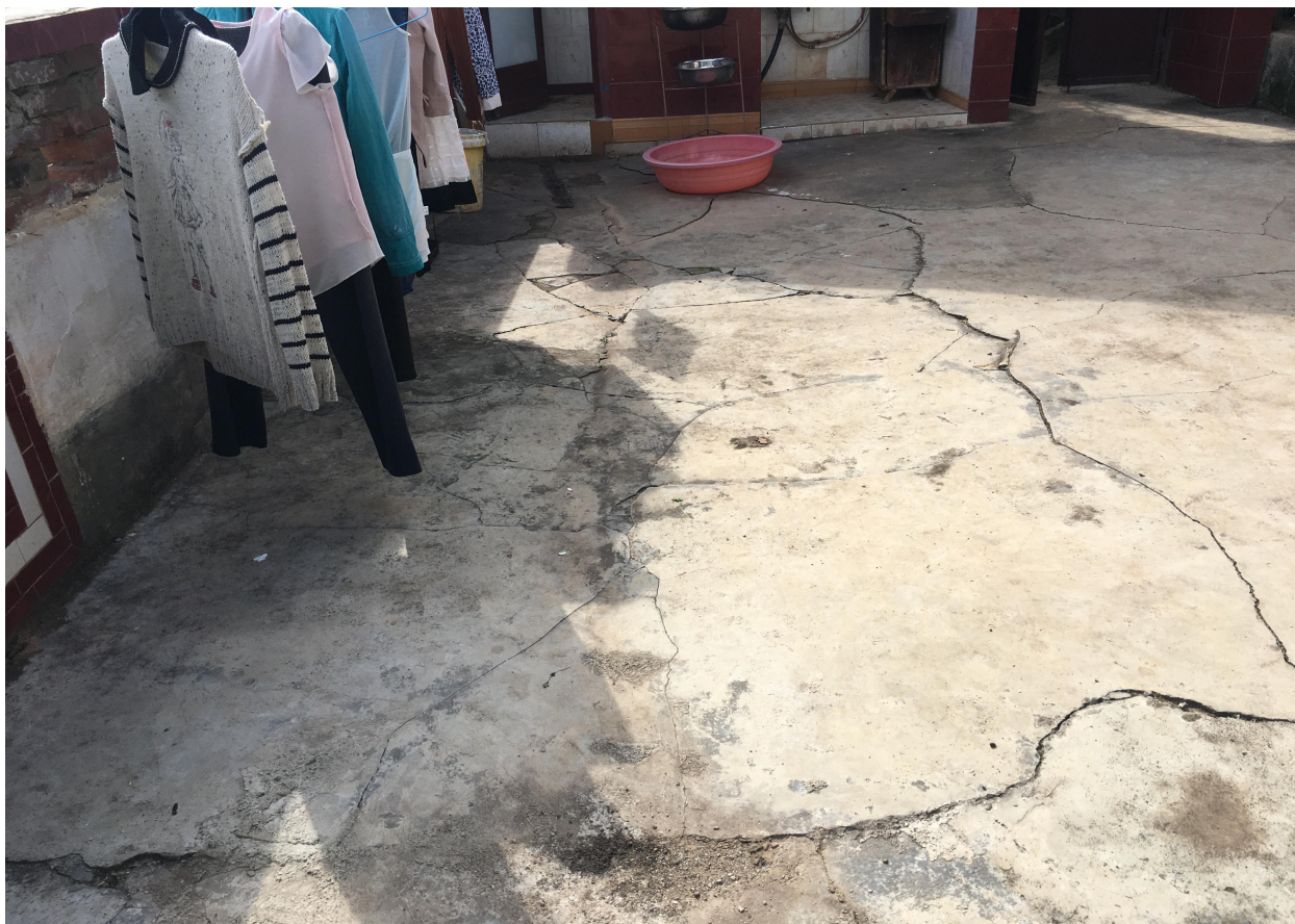
照片 14 房屋裂缝
