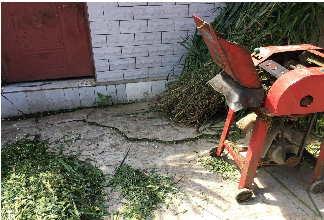
照片 6 地裂缝造成房屋开裂
