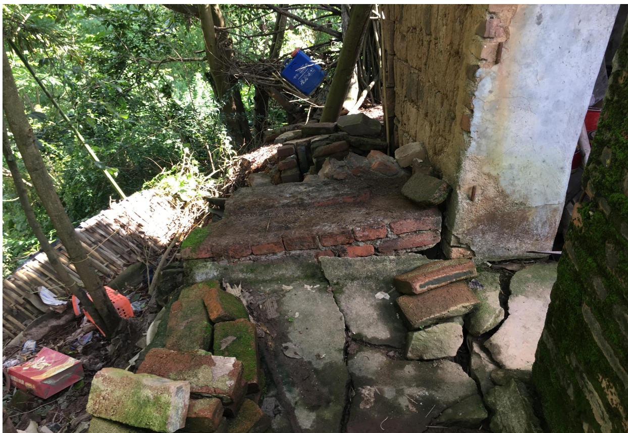
照片 12 房屋裂缝
