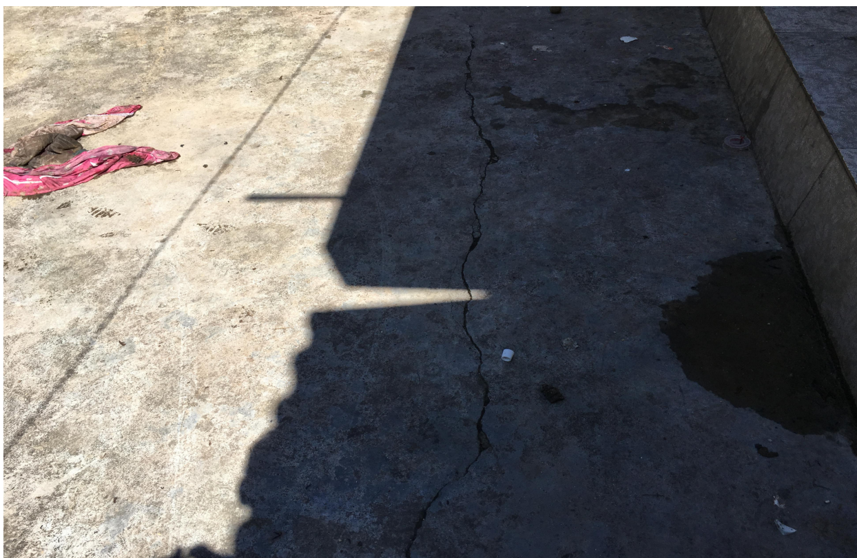
照片 4 地裂缝造成房屋开裂
