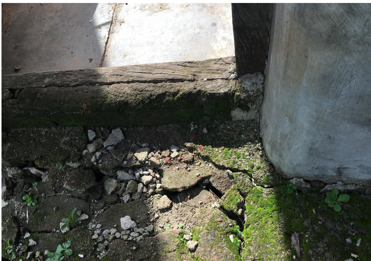
照片 13 房屋裂缝
