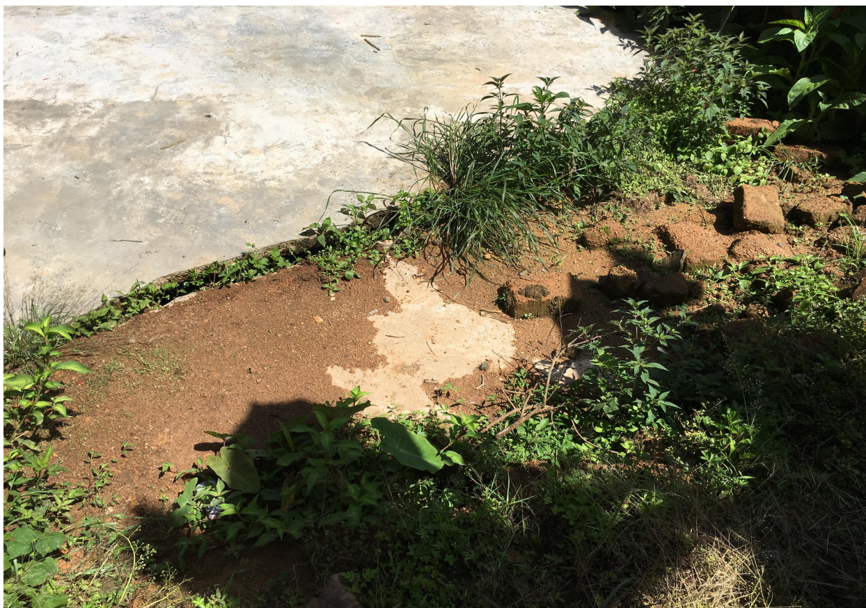
照片 3 斜坡见地裂缝
