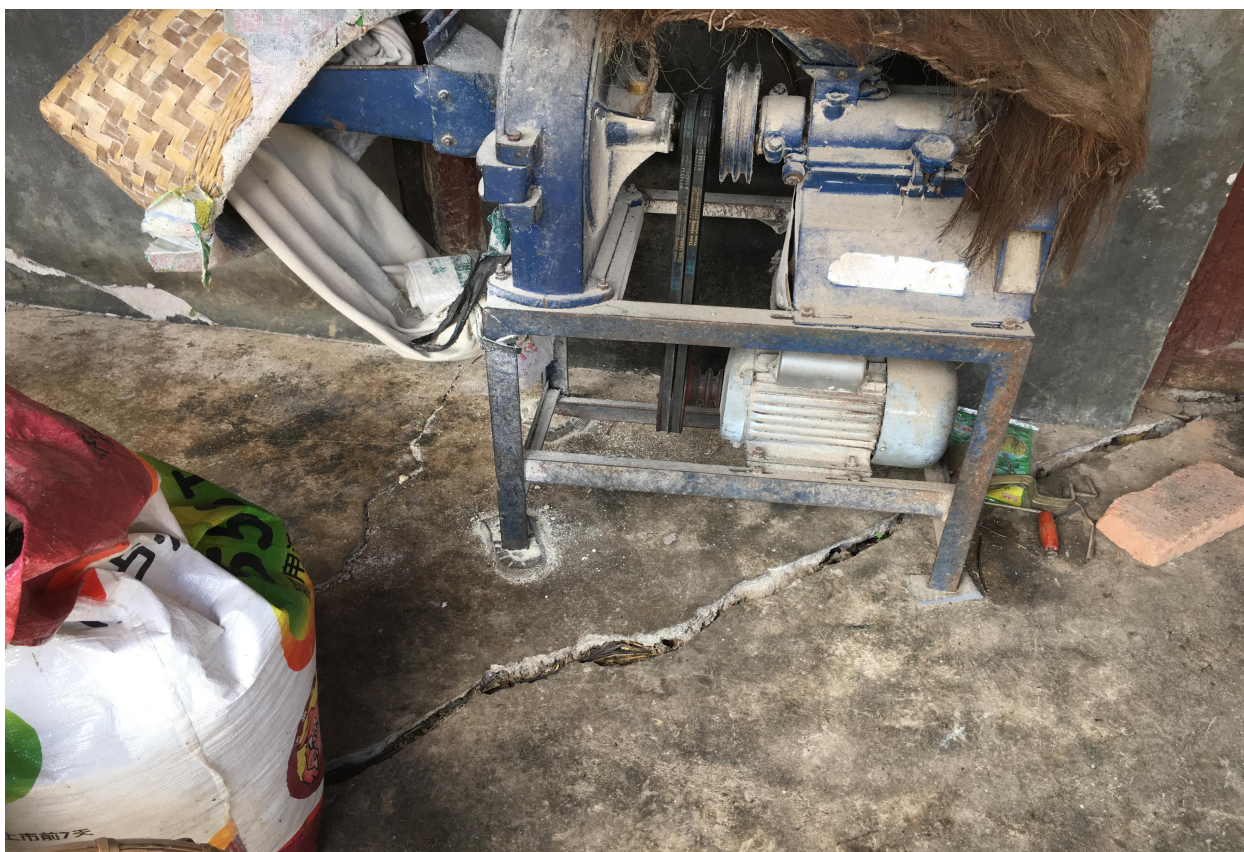
照片 5 地裂缝造成房屋开裂
