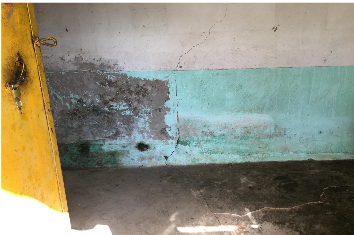
照片 15 房屋裂缝
