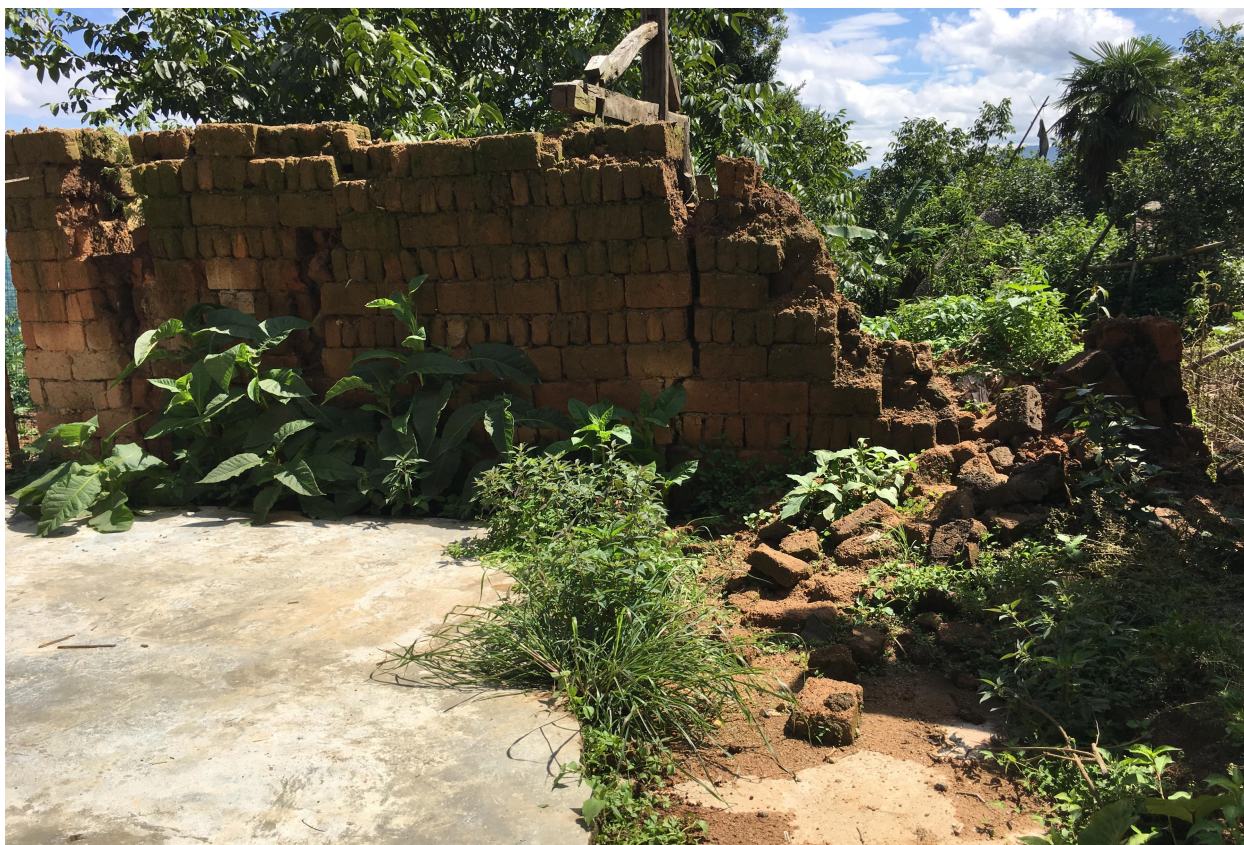
照片 7 地裂缝造成房屋倒塌
